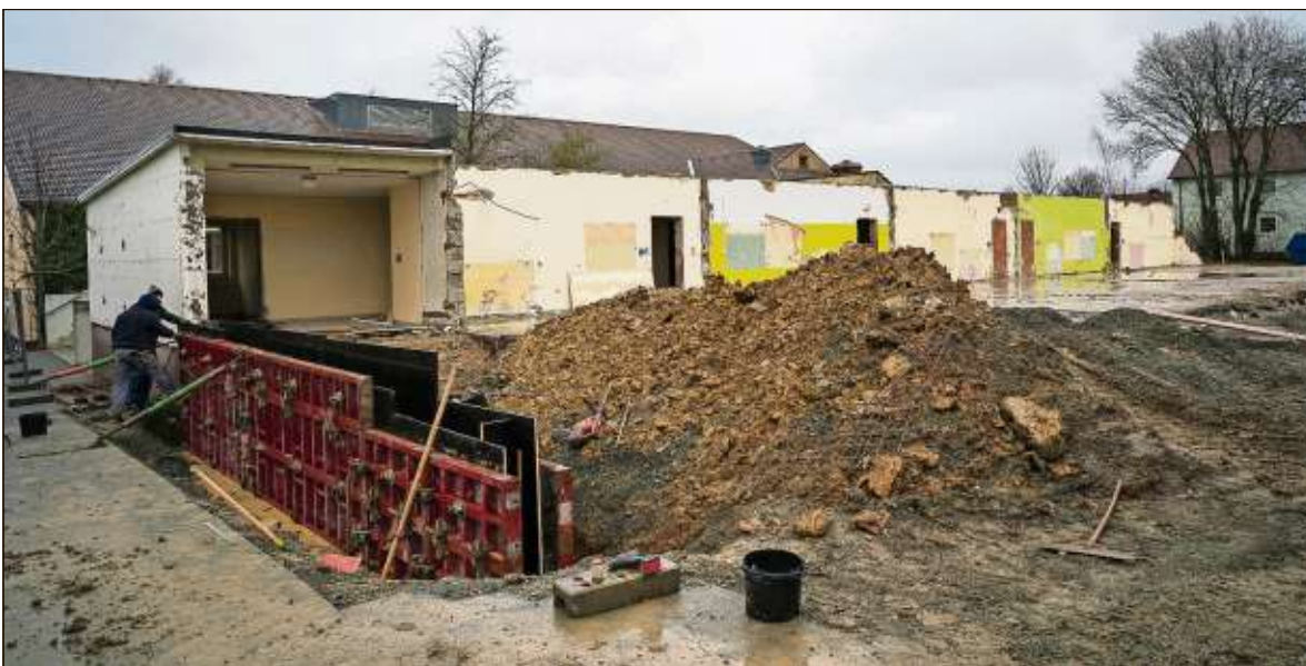
Viel steht nicht mehr von der ehemaligen Berg-Schule, seit das marode Dach abgenommen ist. Auch die vordere Fassade musste abgebrochen werden. Deshalb verschiebt sich auch die geplante Eröffnung von Juli bis in den Dezember. Foto: Eric Waha
